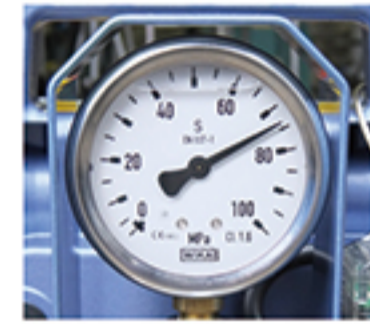
油圧ポンプの 最大圧力
