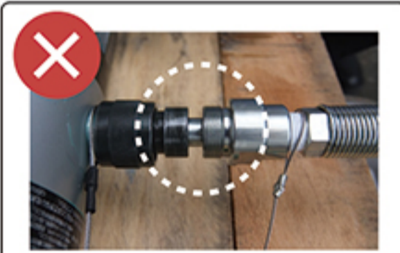
カブラー差込みの悪い例 ねじ部分に隙間あり
